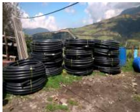
Materiales para el sistema de agua
