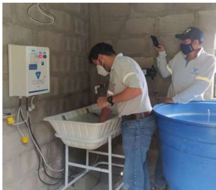
Sistema de cloración en Pinantura.
